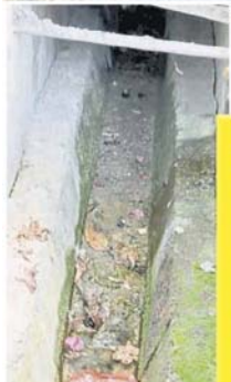
一溝渠內有許多泥沙，沒有清理掉，恐怕會為水災埋下伏筆。
